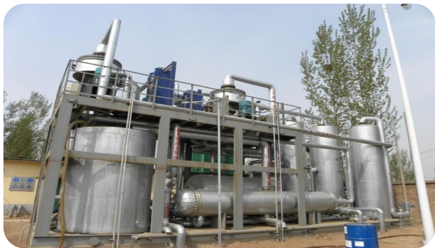
化学吸收脱碳系统
